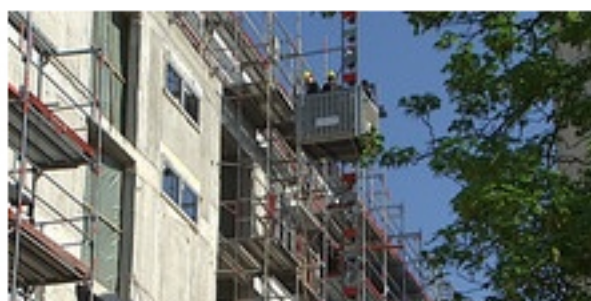
Die neuen Gebäude stehen inzwischen, aber der Bau ist längst nicht fertig.
