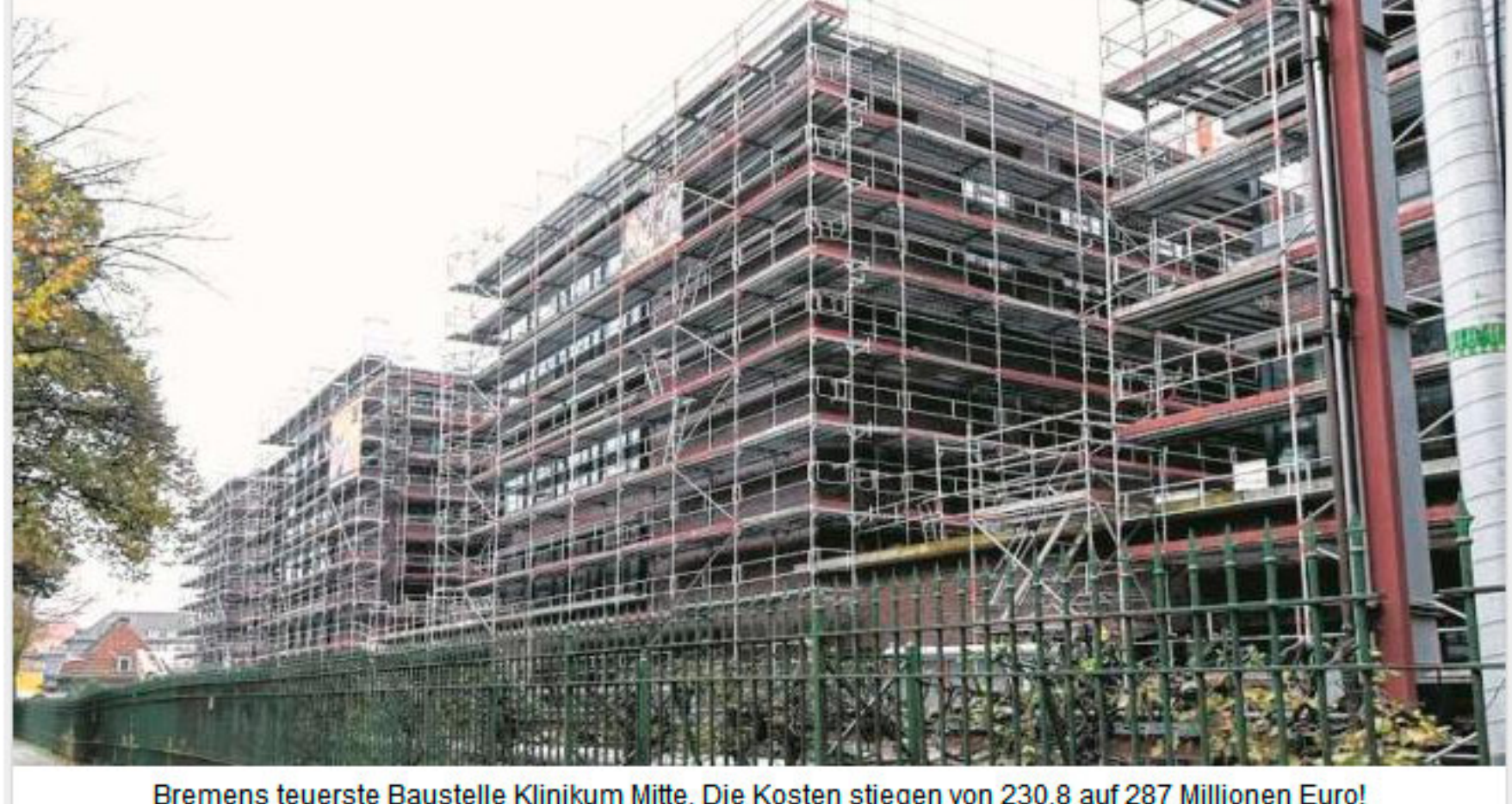
Bremens teuerste Baustelle Klinikum Mitte. Die Kosten stiegen von 230,8 auf 287 Millionen Euro! Foto: Sandra Beckefeldt
