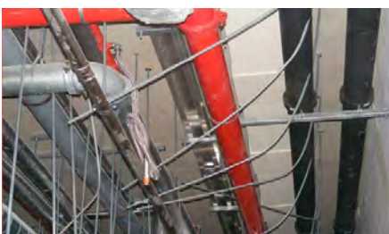
Decken-Abhänger wurden bei Arbeiten nachfolgender Gewerke in Mitleidenschaft gezogen und sind beschädigt und verbogen worden
