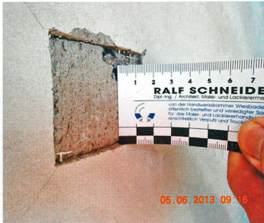
8 Der Fremdüberwacher begleitet den weiteren Bauablauf. So wurde die Dicke von Unterputz-/Armierung geprüft.
