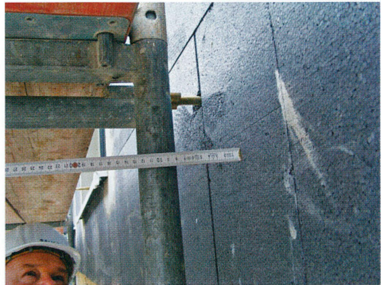
9 Der Abstand zwischen Gerüst und Fassade war zu gering dimensioniert. So ist eine gleichmäßige Oberputzstrukturierung nicht möglich.
